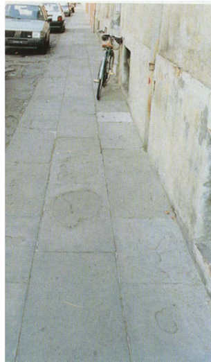
PARTICOLARE 2 ARENARIA CON "SFALDATURA" DA GELO (CORSO CAVOUR)
