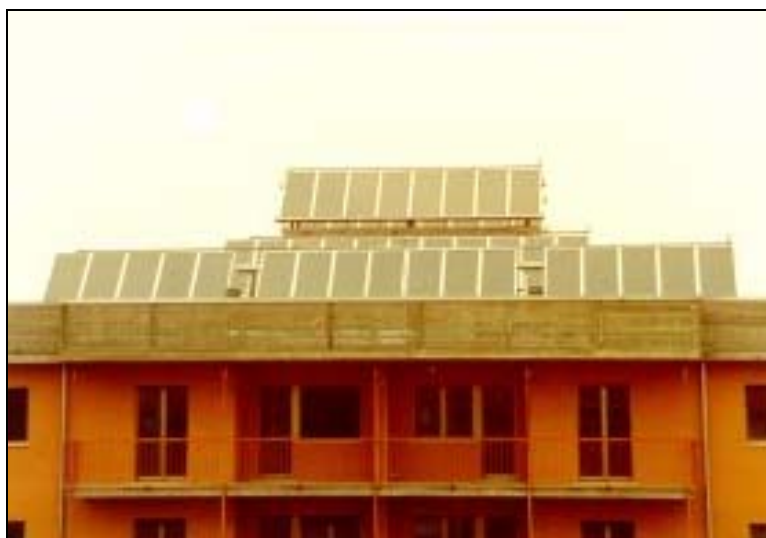
Fig. 3.3.3 – Impianto solare termico per la produzione di acqua calda
