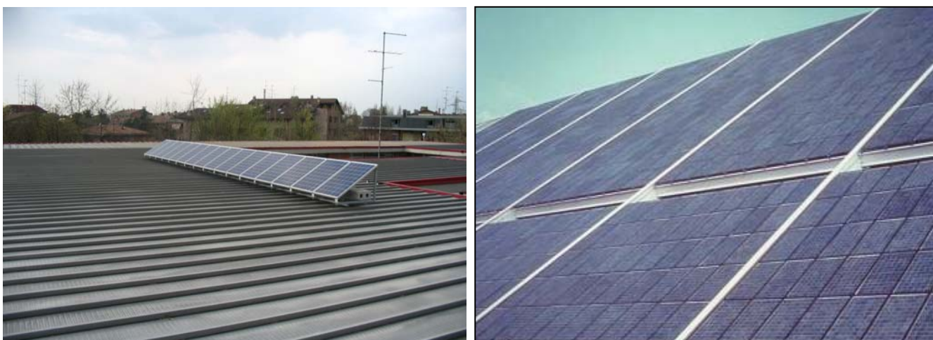
Fig. 3.3.2 – Impianto fotovoltaici per la produzione di elettricità
